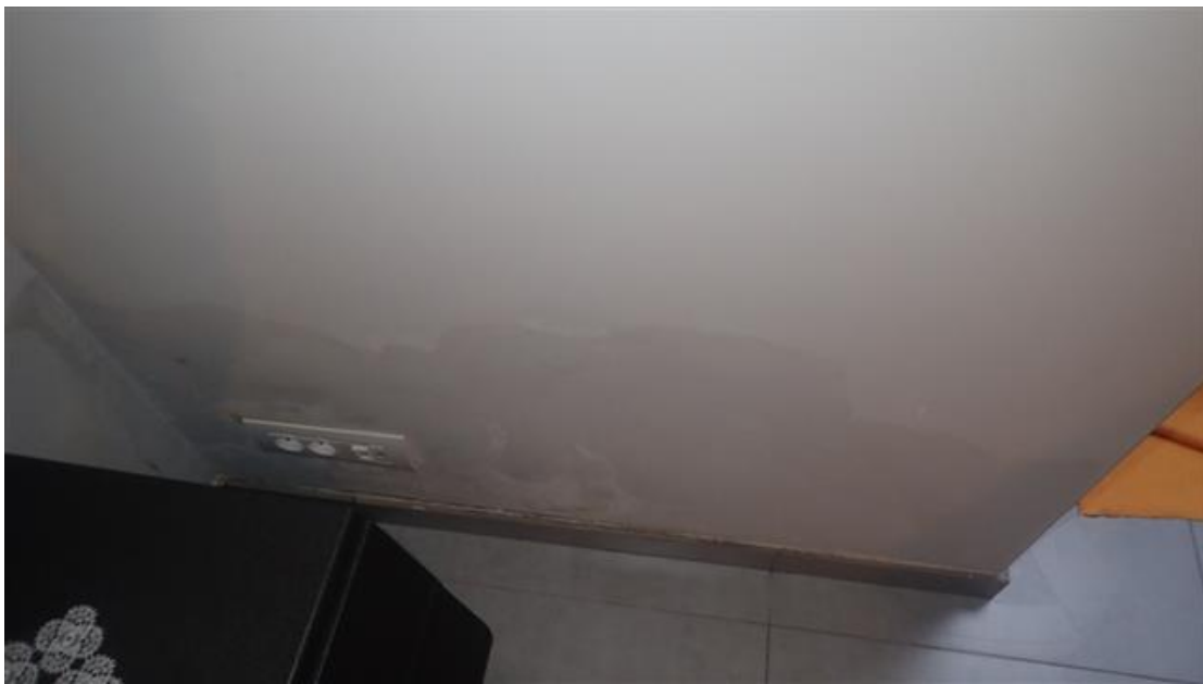
Opstijgend vocht + stopcontact
