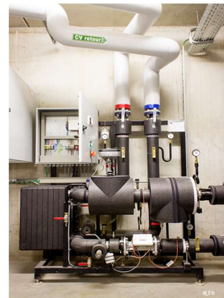
IWAS (Indirect Warmte Afgifte Station) - > >70kW
