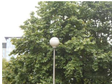
Openbare verlichting waarvan de doeltreffendheid sterk dreigt te worden verminderd door de begroeiing.
