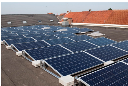
Jannemieke, Zaventem (09/2020) 57 panelen, 16.25 kWp Jaarlijkse productie: 15 MWh Jaarlijkse CO 2 besparing: 3.9 ton
