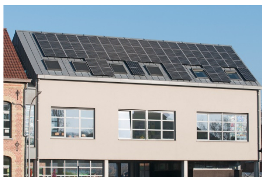
Kouterschool, Londerzeel (11/2020) 38 panelen, 14.06 kWp Jaarlijkse productie: 13 MWh Jaarlijkse CO 2 besparing: 3.4 ton
