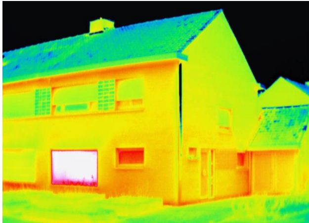
Warmtecamerabeelden – eigen werk
