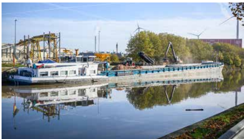
Zie ginds komt de puinboot. Tonnen steenpuin van de sloop van de oude gebouwen vertrokken per boot. Dat spaarde vele vrachtwagens uit op de weg.
